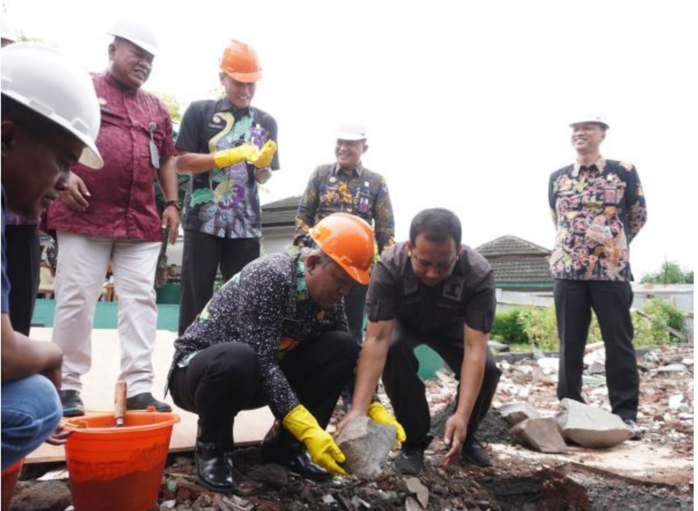
Bangun Kembali Masjid At-Taubah Lapas Semarang, Kakanwil Kemenkumham Jateng Letakkan Batu Pertama
